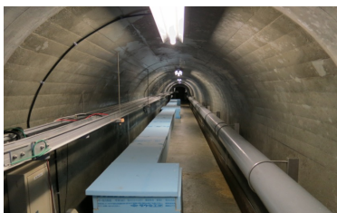
図2. 北海道大学の樽前山坑道観測点延長約130mのY字型のトンネルの内部に、地震計、強震計、水管傾斜計、伸縮計が設置されている
